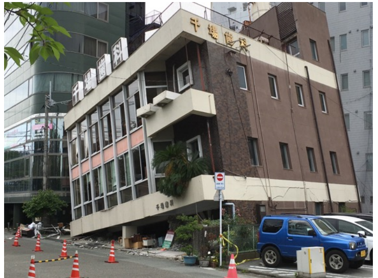
写真19 倒壊した3階建てRC造ビル
