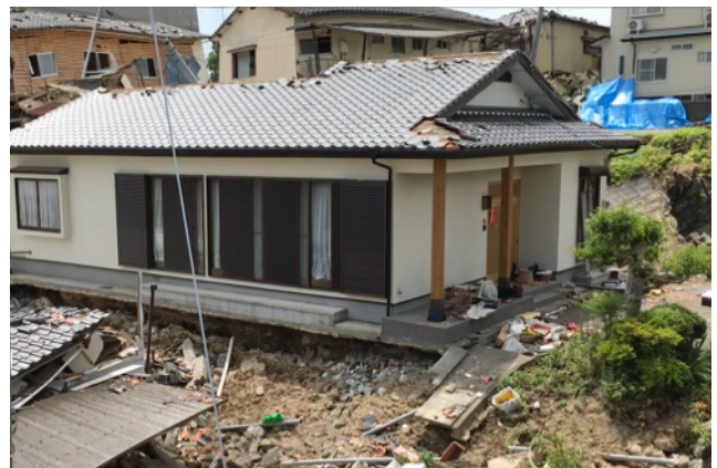
写真3 擁壁崩壊でもベタ基礎の住宅は無事
