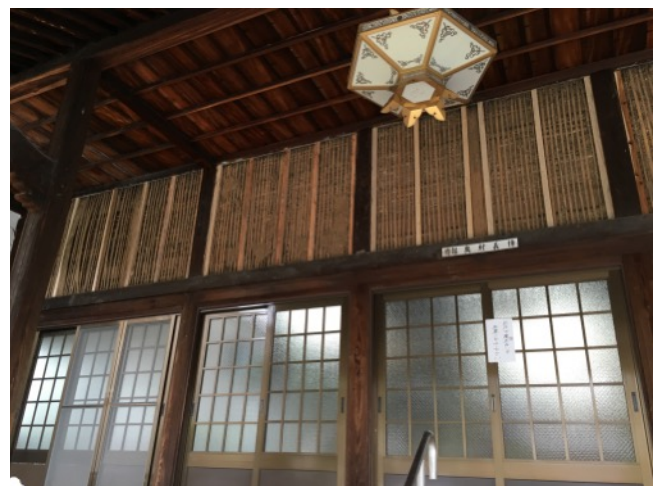
写真26 土壁のはがれた専光寺（並木坂近く）
