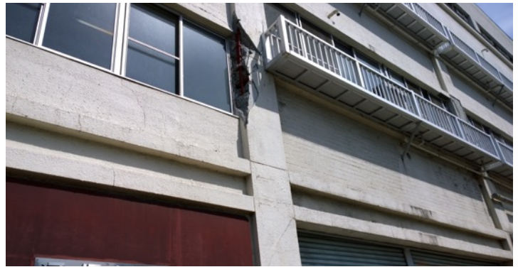
写真29 2階柱がせん断破壊したRC造ビル
