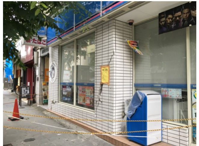
写真24 RCビルの1階柱がせん断破壊（並木坂）
