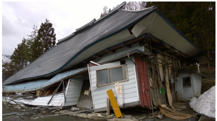
写真38 積雪により倒壊した住宅（2015年4月）
