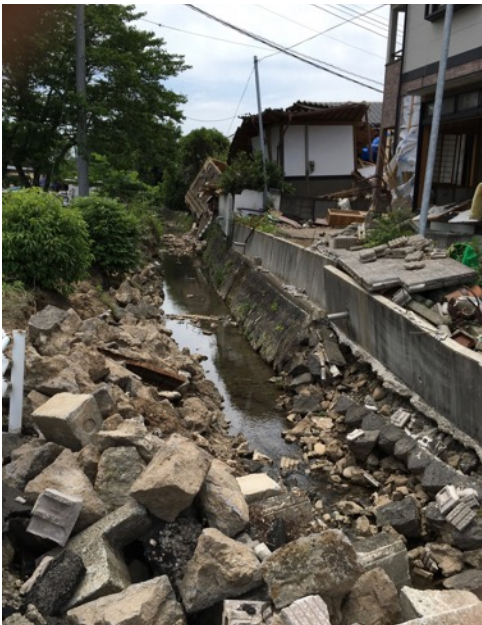
写真6 擁壁の崩壊した小河川
