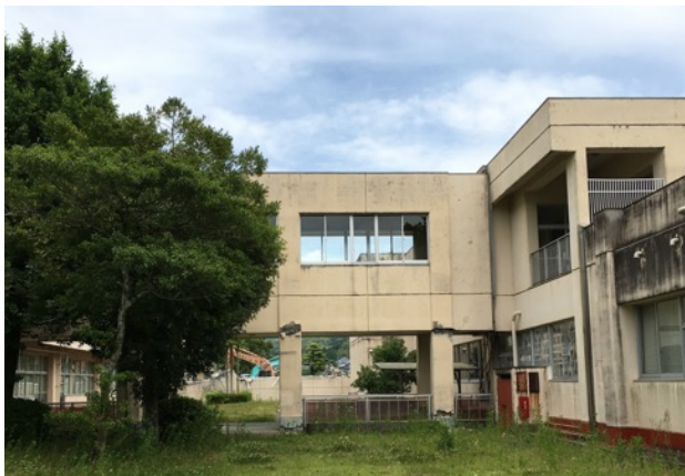
写真11 木山中学校（渡り廊下の柱破壊）
