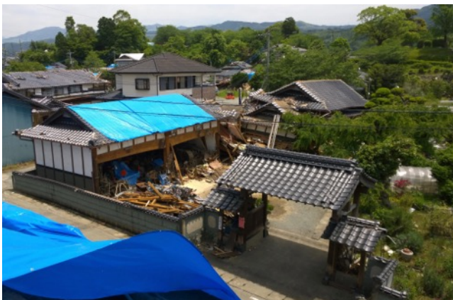
写真2 大破しながら倒壊しない伝統的工法の民家
