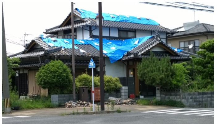
写真14 宇土駅近くの木造住宅（屋根瓦落下）
