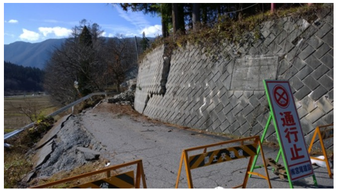
写真35 大きく崩れた擁壁
