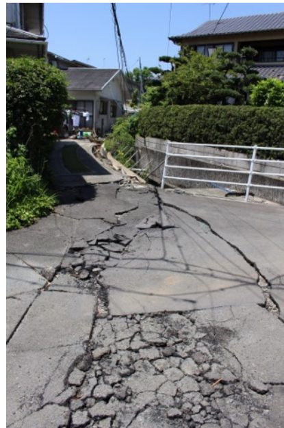
写真7 小河川近くの道路変状
