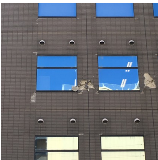
写真21 カーテンウォールのせん断破壊
