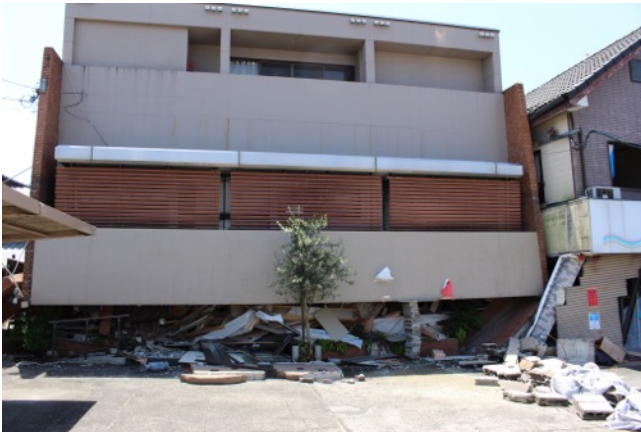
写真4 1階が倒壊したRC造3階建て住宅
