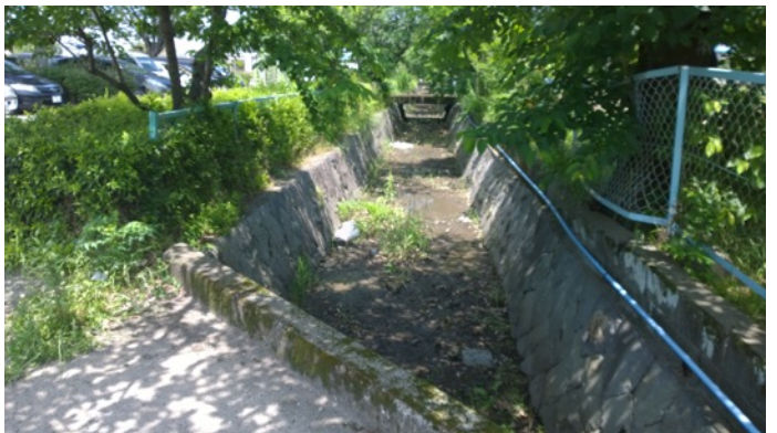
写真16 水涸れした水路（宇土市役所近く）
