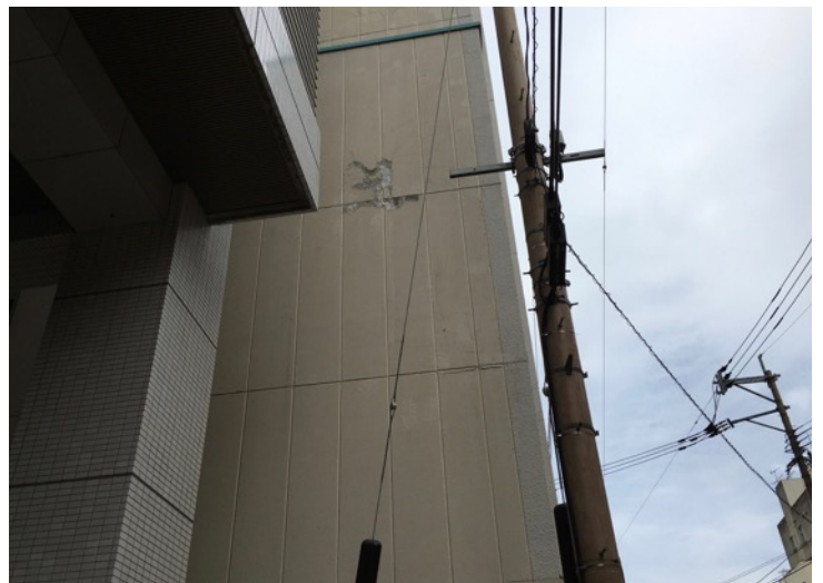
写真20 衝突跡のような部分破壊のある中高層ビル
