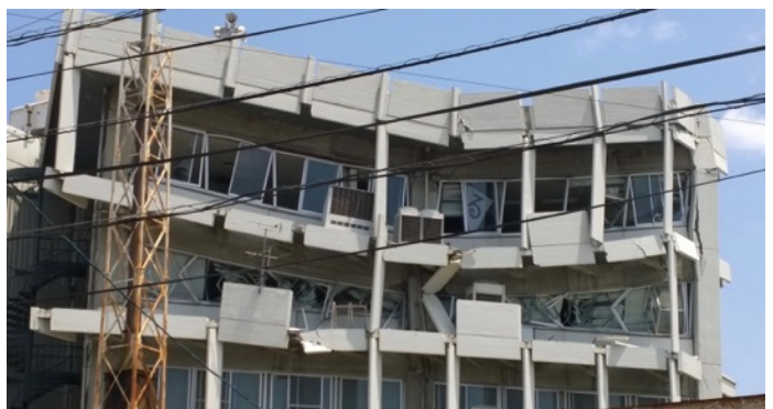
写真15 4階が層崩壊した宇土市役所（外周のPCa柱は落下）
