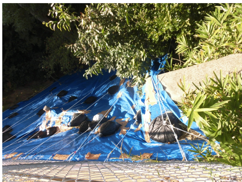
議論の的となったマンションわきの土砂崩れ現場
