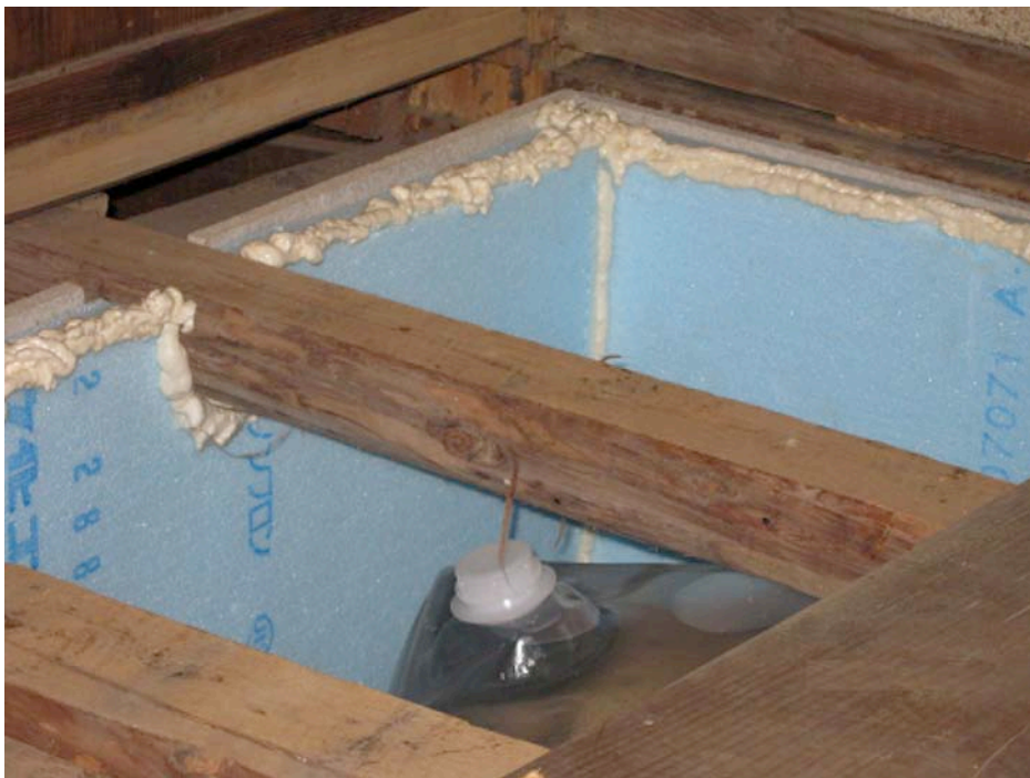
基礎断熱部分 蓄熱用には水タンクを床下に配置した
