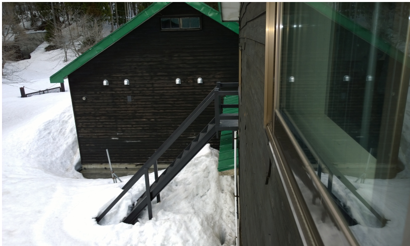
長期間雪に埋もれ 錆びて危険な鉄骨階段
