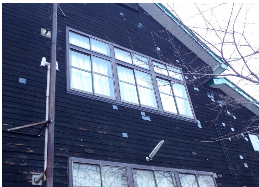
改修前の外壁 キツツキ被害の様子
